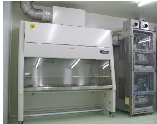
設置例 (ABSL3 室内)
